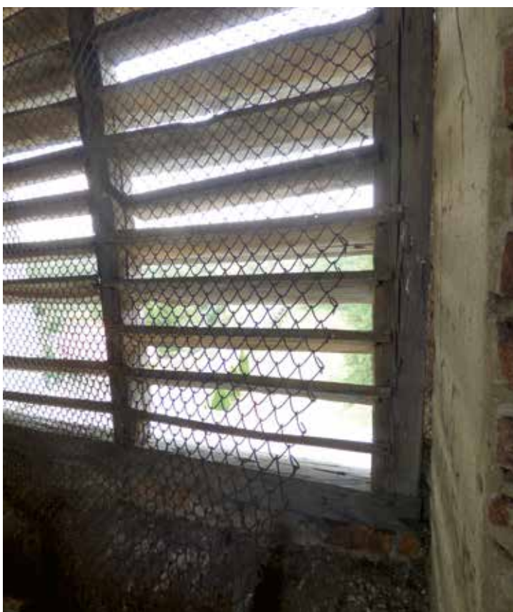
3. ábra: A nem megfelelően rögzített háló veszélyt jelenthet a gyöngybagolyok ( Tyto alba ) számára. Az épületbe való bejutást nem gátolja meg, de a kijutást megnehezíti, így csapdaként funkcionálhat (fotó: Móczár Balázs) / Improperly secured nets can pose a danger to the Western Barn Owls. While they do not prevent entry into the building, they make it difficult for the owls to exit, potentially functioning as traps
