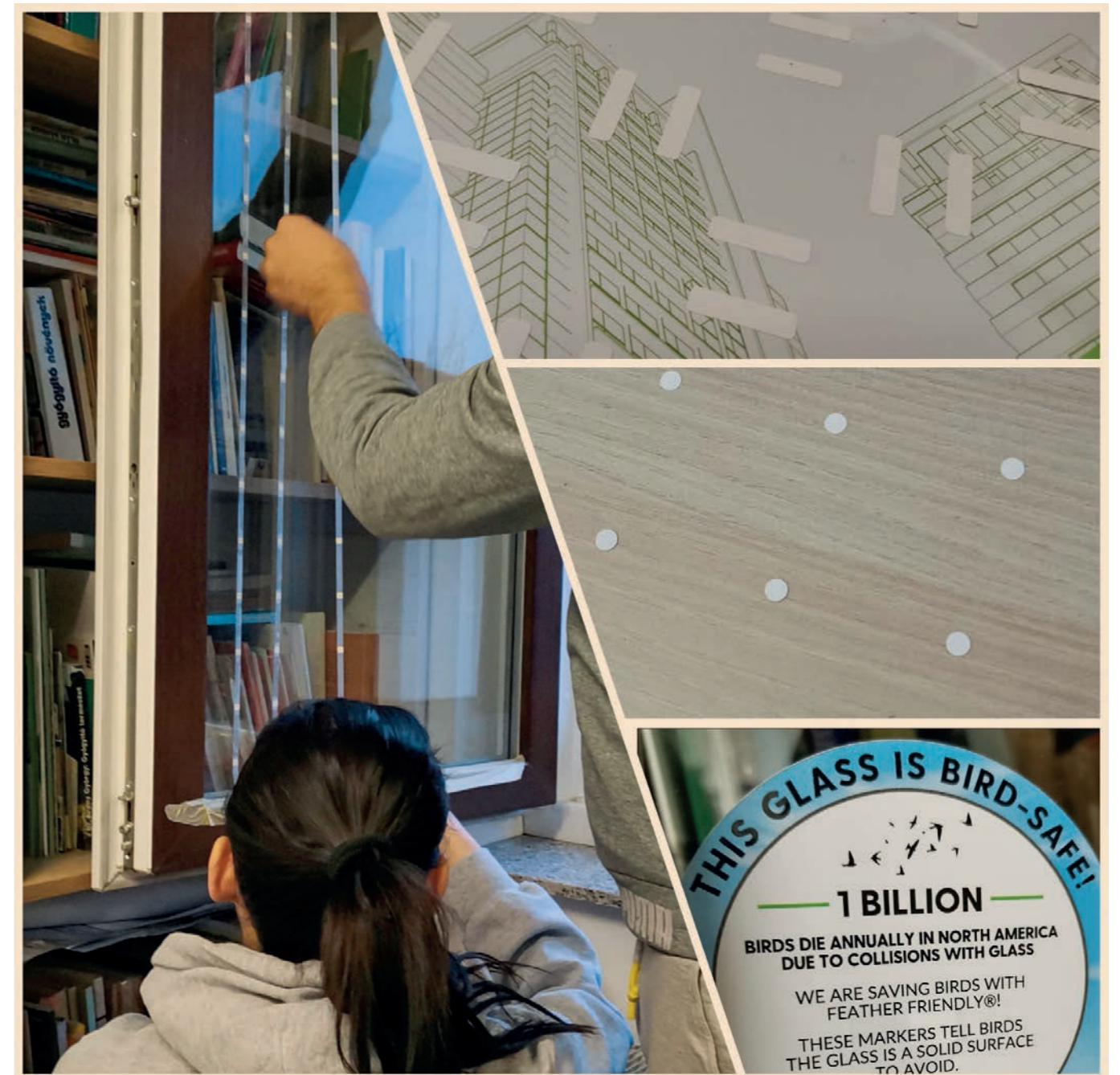
A tesztelés során a megadott technikai instrukciók szerint rögzítettük a Feather Friendly ütközésvédelmi matricáit. Az együttműködés részletei elérhetőek a One Planet oldalán ( https://www.oneplanetnetwork.org/knowledge-centre/projects/testing-bird-collision-protection-systems ), az erről készült esettanulmány pedig a szerzőnél is elérhető (a szerző saját fotói)
