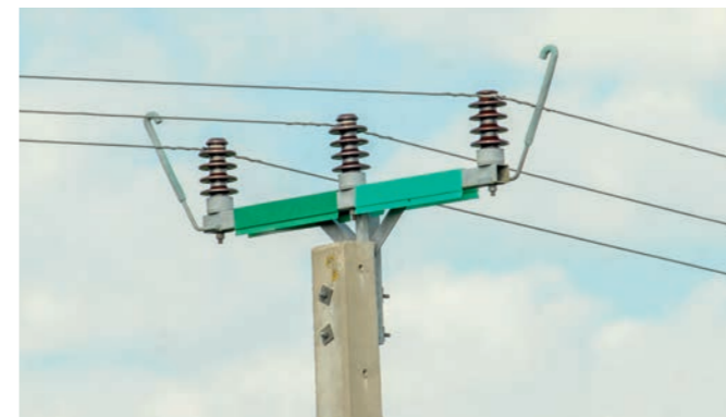
A középvezettségű légvezeték tartóoszlopain a keresztartó vas szigetelése alá is építenek fészket a mezei verébek
