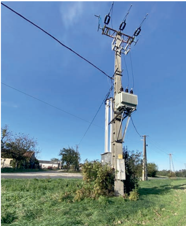
14. ábra: Kiegészítő szerelvényekkel átalakított OTR-állomás Csér településen. Az alul vezetett, burkolt áramkötések és a madárkiülők ellenére 2021-ben fehér gólya ( Ciconia ciconia ), 2024-ben pedig gyöngybagoly ( Tyto alba ) pusztult el rajta. Ennek a fehér gólya esetében legvalószínűbb oka, hogy a régi, rövid feszítőszigetelőkre nem került fel szárnyterelő lap (fotó: György Előd) / OTR station retrofitted with additional fittings – in the settlement of Csér. Despite the covered MV cables fixed under the upper plane of the head structure, and bird perching rod set, a White Stork died there in 2021 and a Western Barn Owl in 2024. The most likely reason for this in case of the Whit Stork is that the old, short tension insulators aren’t equipped with wing-spacer plates
