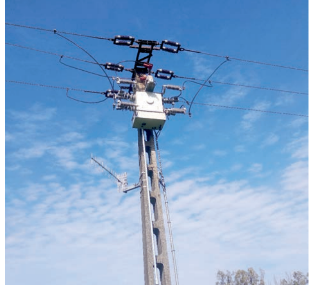
11. ábra: A modern, burkolt áramkötésekkel szerelt berendezés sem old meg mindent: hagyományos, veszélyes feszítő-fejszerkezet maradt az oszlopcsúcson, 2024, Szőgye (fotó: Győrig Előd) / A modern device equipped with covered MV cables does not solve everything: a traditional, dangerous tension head structure remains at the top of the pole, 2024, Szőgye
