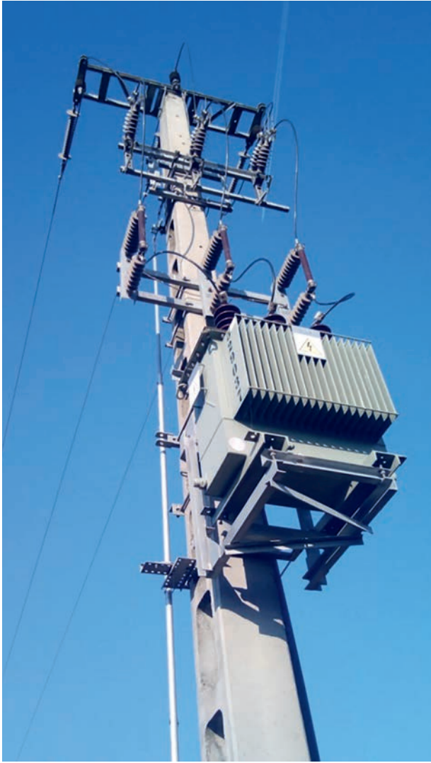
17. ábra: Fehér gólyáink ( Ciconia ciconia ) számára kedvező kialakítást a hosszú feszítőszigetelével szerelt, és alul vezetett, burkolt áramkötésekkel kialakított feszítőoszlopok jelenthetnek, ahol a gép (mint ennél az OTR-állomásnál is) a beérkező sodronyokkal átellenes oldalra kerül (fotó: György Előd) / A preferred bird-friendly design for White Storks could be tension poles equipped with long tension insulators and covered connection cables under the head structure, where the machine (as at this transformer station) is located on the opposite side to the incoming wires
