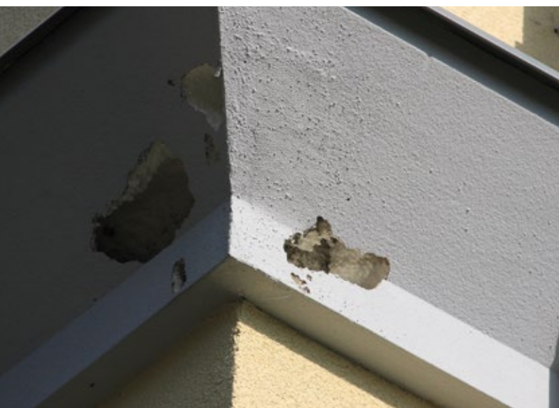
Harkály által kibontott szigetelés
