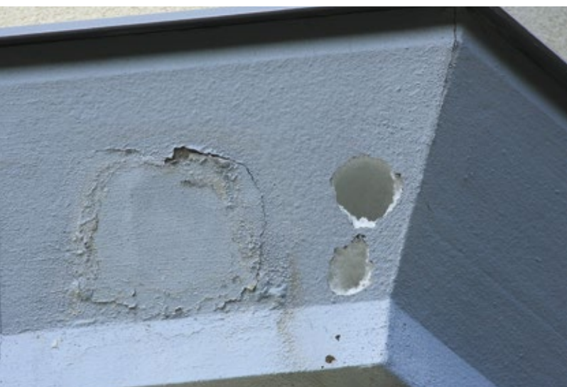
Harkály által kibontott szigetelés
